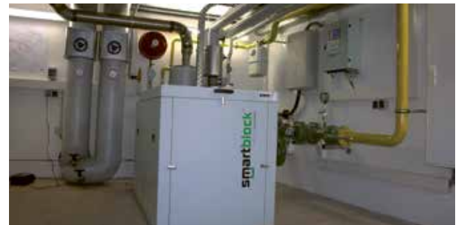
Ein wichtiger Baustein des Neumarkter Klimaschutzes sind KWK-Anlagen (Kraft-Wärmekopplung) mit dezentralen Nahwärmenetzen
