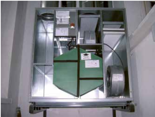
Lüftungsgerät im Innenbereich
